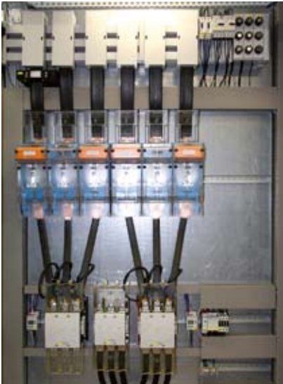
Steuerung Stern-Dreieck-Anlauf 450 kW
