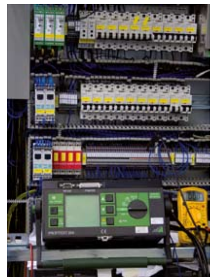
Schaltschrank Endprüfung nach ISO 9001
