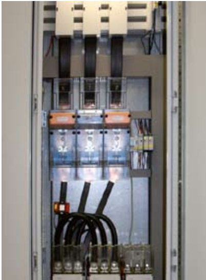
Steuerung Stern-Dreieck-Anlauf 250 kW
